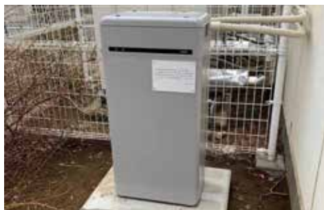
緑ヶ丘公民館 蓄電池
